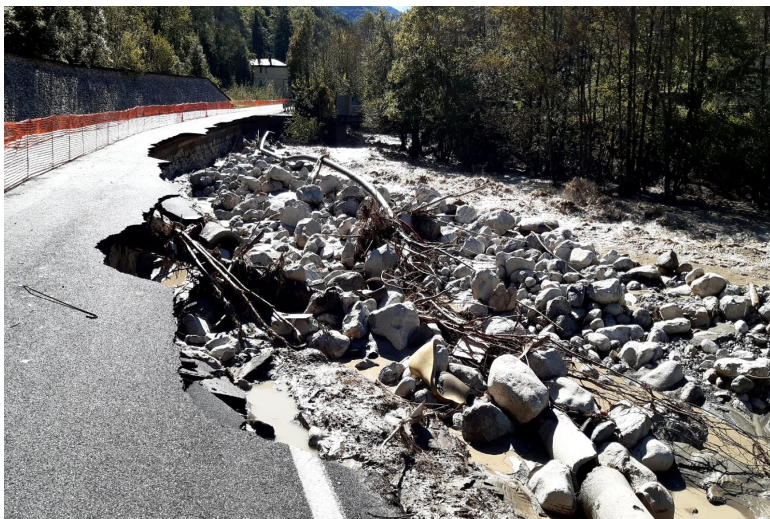
Limone Piemonte (CN) – S.S. 20 “del Colle di Tenda e di Valle Roja” - Torrente Vermenagna.
